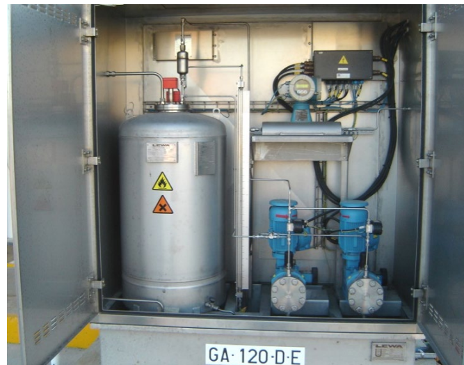
Depósito y bombas THT
